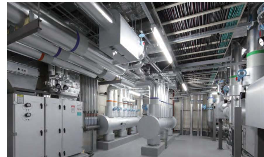
供給棟内部の機械室。電気、空調、衛生などの設備はすべてこの供給棟に配置されている
